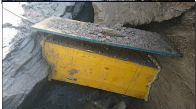
Abbildung 8: Einhausung der Konvergenzextensometer durch die WLW (Sommer 2019)
